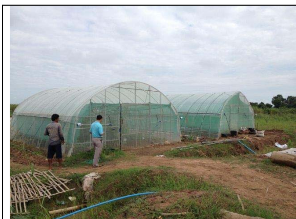
現地部材を一部使用して東都興業が建設・寄贈したグリーンハウス (Arey Ksat試験栽培サイト)
