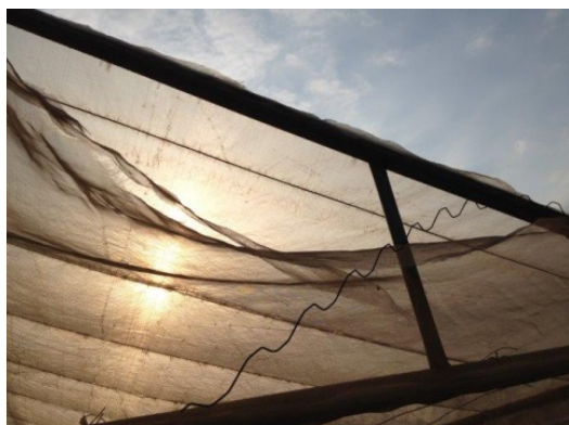
写真：フィルム押さえ材が止め材から外れて隙間ができています GH（中国系民間）
