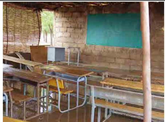
既存小学校の仮設教室 屋根・壁が草ぶきであるため、雨が降ると教室内部が水浸しとなる。同敷地内に中学校を建設する。 (中央北部州サンマテンガ県マルー小学校)
