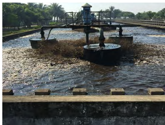
[現場写真] 下水処理場運転状況
