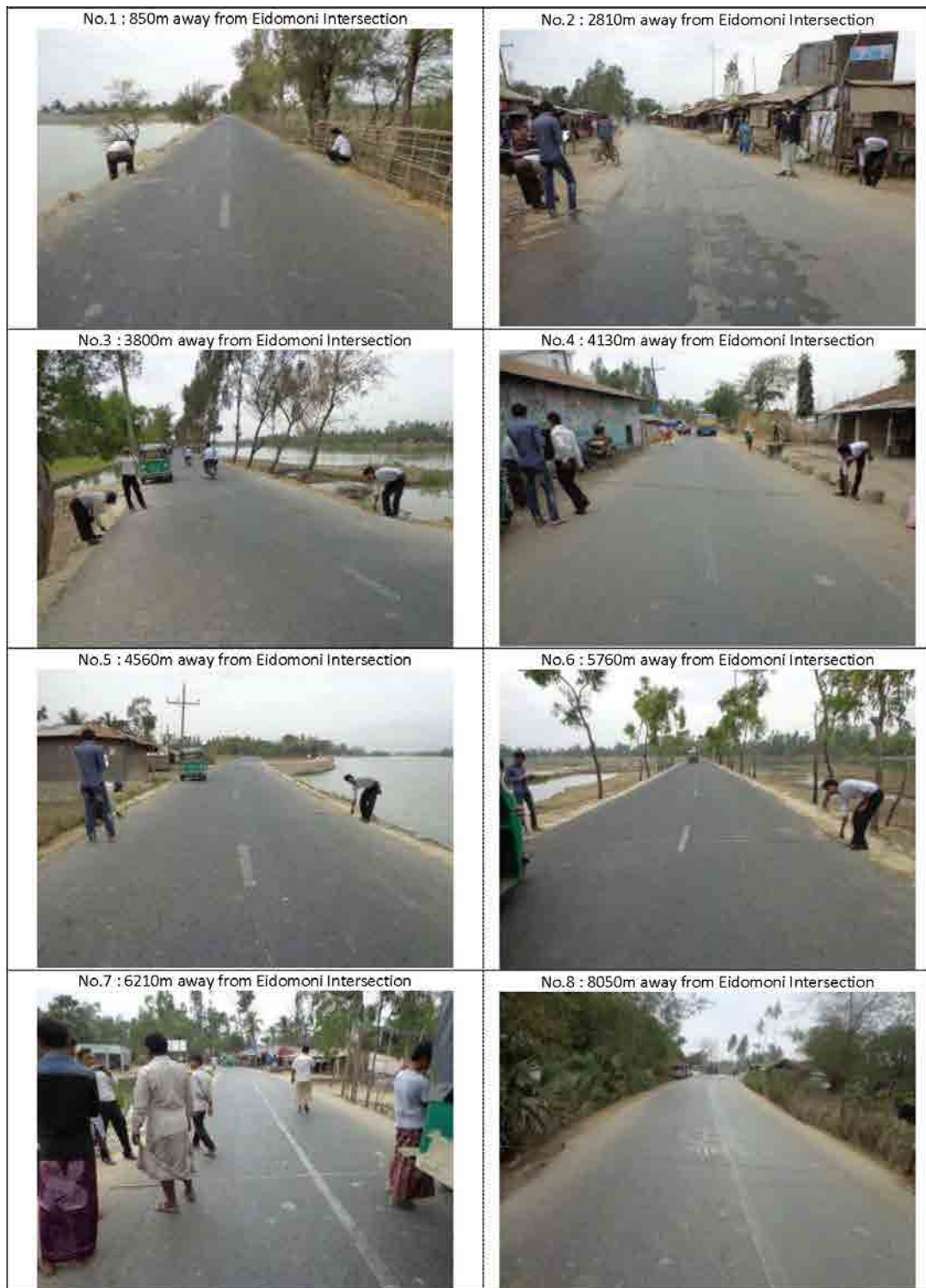
図 16.3-25 選定ルートの写真（Eidomoni 交差点から Badarkhali 橋を通り、Yunuskhali 交差点へ）
