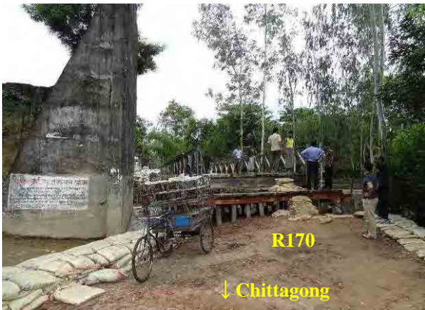
調査時に車両通行できなかった橋 (Pekua)
