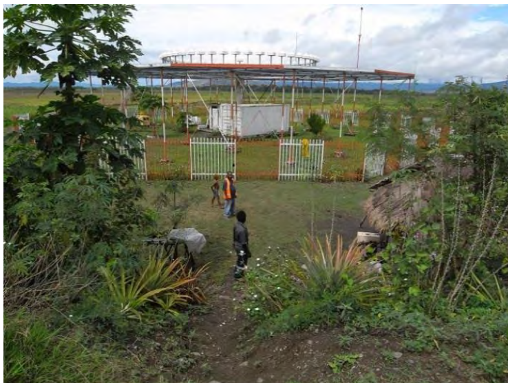
写真 13.4-1 滑走路先端付近に設置される BOR (右端の茅葺屋根は管理小屋)
