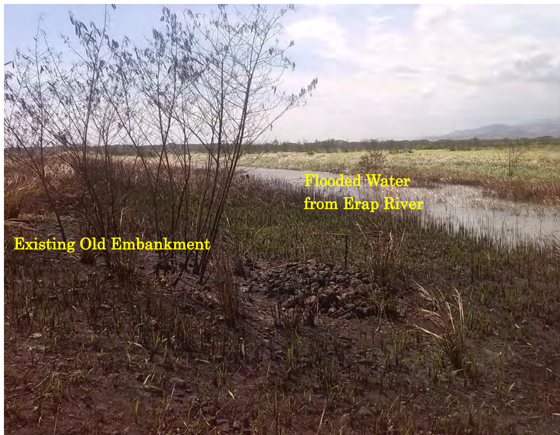
写真2：エラップ川から氾濫した水と既存の老朽化した堤防
