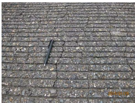
(グルーピングされた滑走路舗装のクラック)
