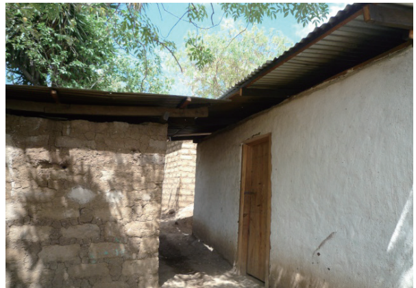
住居改善活動により修繕された家屋 (写真左：修繕前、写真右：修繕後) (エステリ県)
