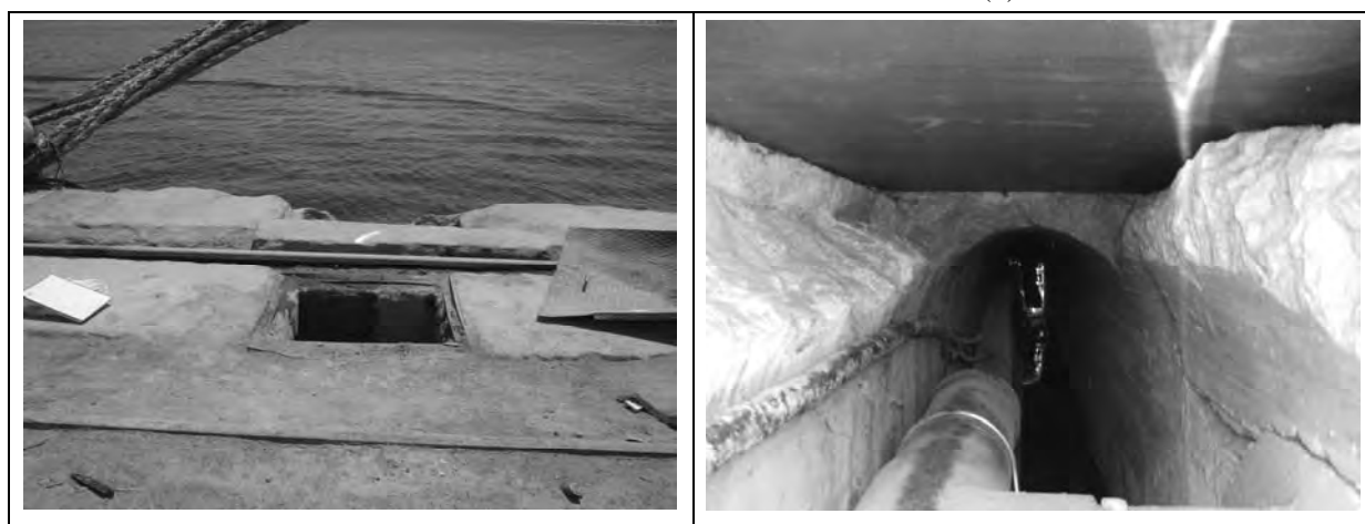
図-2-1-4-(2)-3 共同溝の状況
