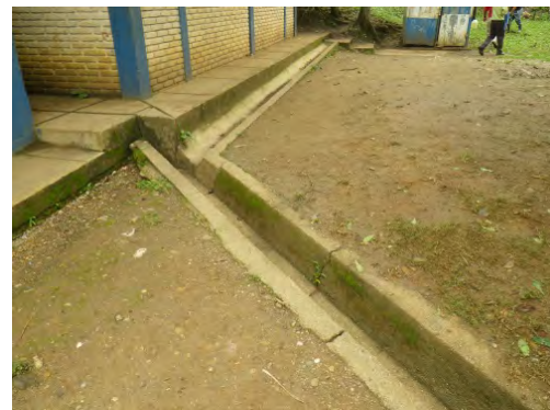
Fotografía 2-3 Fisuras que se produjeron dentro del terreno de la escuela
