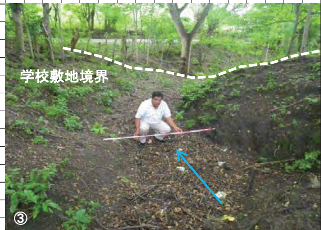
学校からの表面流による侵食
