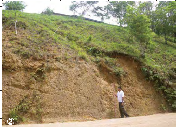
② 急斜面下部の切土部分に生じた侵食
