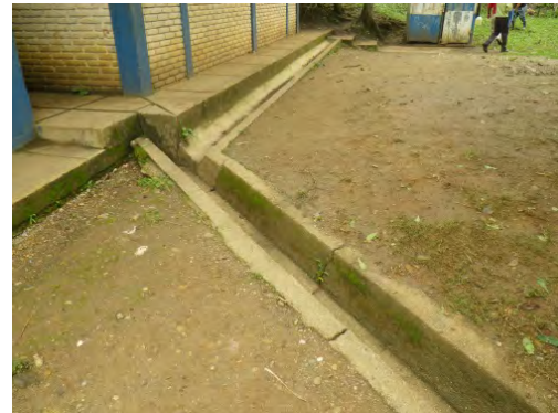
写真 3-3 学校敷地内に発生したクラック
