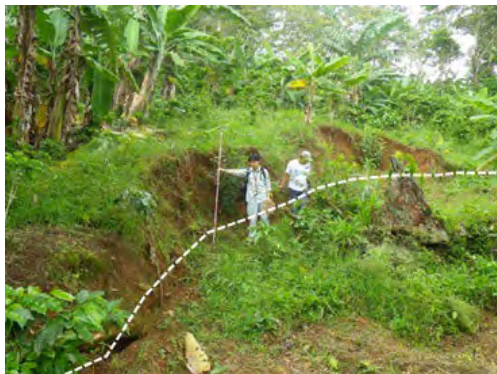
写真 3-2 学校敷地直近の滑落崖
