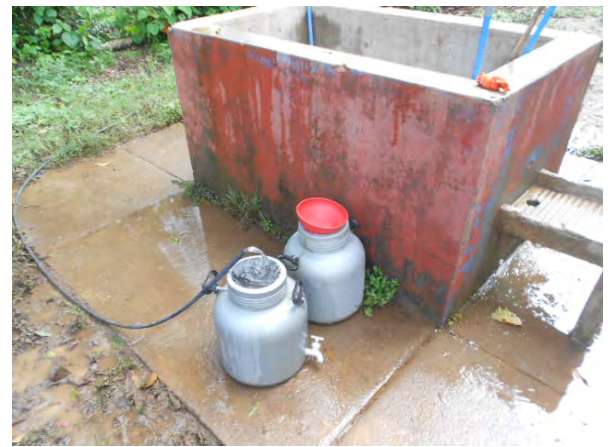
写真-29：水源の様子 山から湧き水をパイプで引いている。（ヌエバ・セゴビア県ウィリウィリ市ブエナ・ビスタ・デ・ベンティージャ、NS-16）
