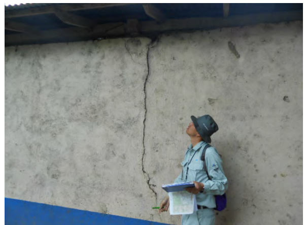
写真-11：既存校舎 既存校舎の壁面にあるクラック。(ヌエバ・セゴビア県ハラパ市ベインティーヌエバ・デ・フニオ, NS-5)
