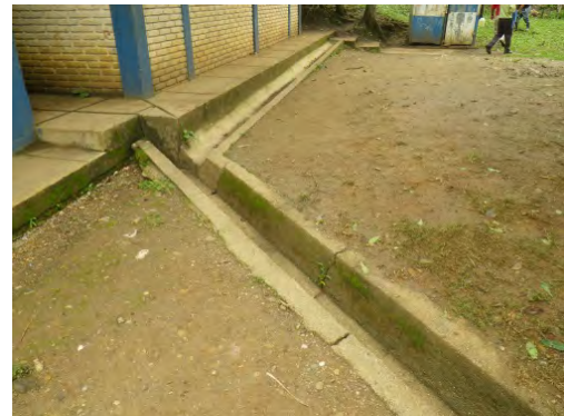
写真 3-3 学校敷地内に発生したクラック
