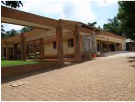
既存トッフオ CSC
