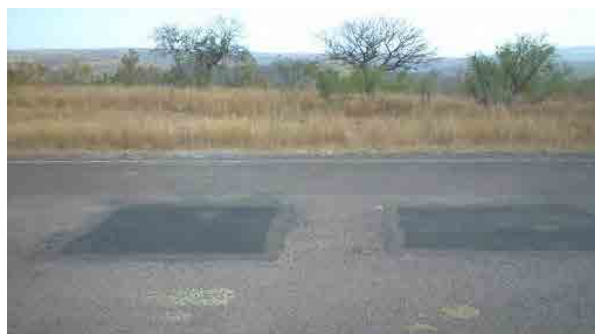
パイロットプロジェクト区間におけるポットホール補修箇所
