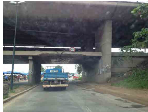
ボアニ（第1）橋（車両の衝突により破損している）
