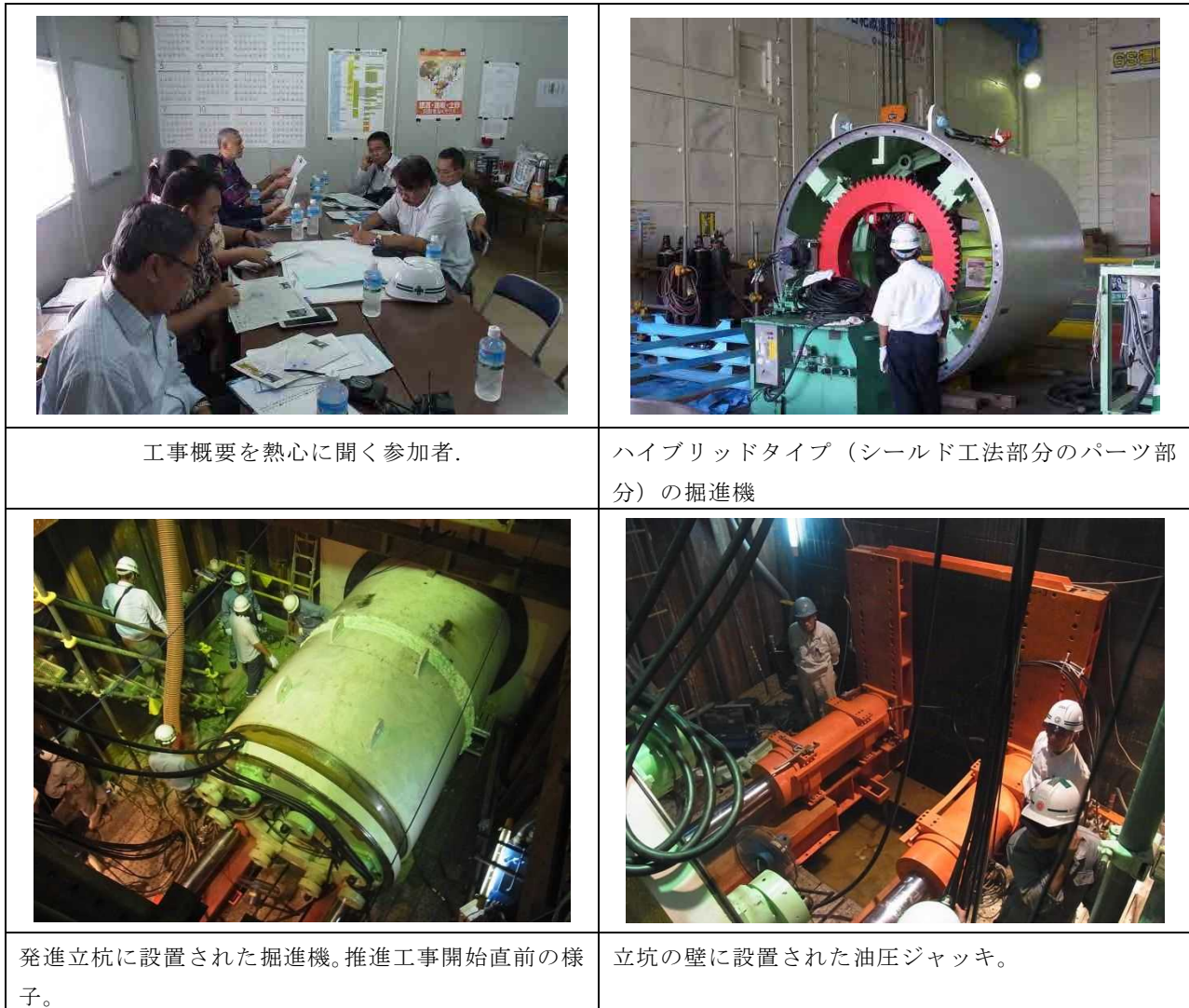
図 6.3 推進工法による明石市の雨水管渠工事現場の視察の様子
