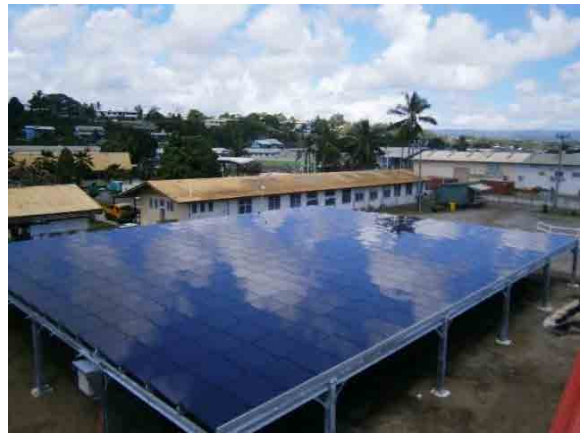
太陽光発電システム全景
