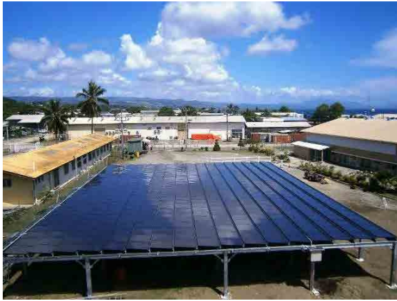
太陽光発電システム全景
