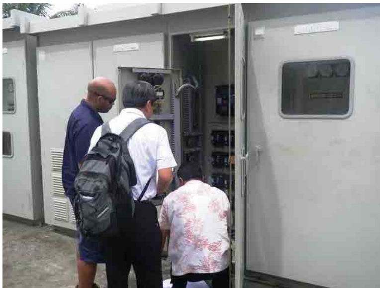
写真 2. 連系点となる既設盤内の確認
