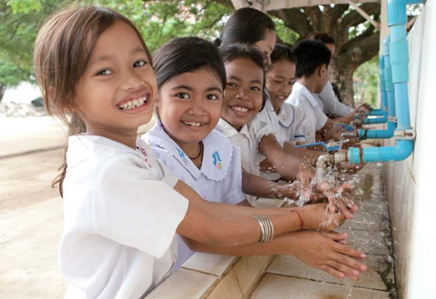
Cambodge : Des enfants dans une école primaire au Cambodge. L'eau salubre est fournie par des installations développées avec l'aide de la JICA.
