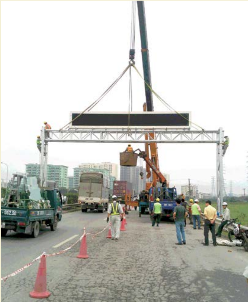
Installation sur une autoroute de Hanoï, au Vietnam, d'un système de contrôle de la circulation financé par un don.
