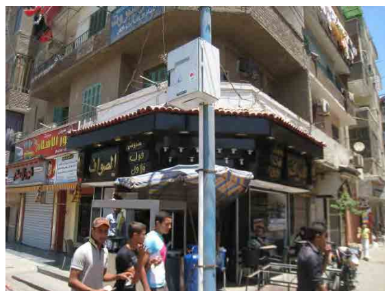
設置されたテレメータ装置。(2013年5月)
