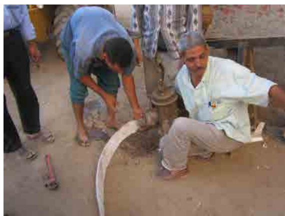
パイロット地区分離化のための消火栓作動状況テスト。(2011年10月)
