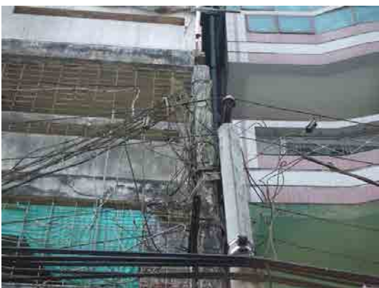
電線がむき出し状態の箇所も多い
