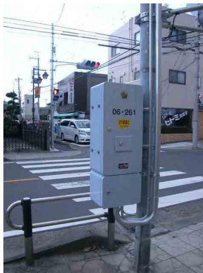
交通信号制御機：日信電設撮影
