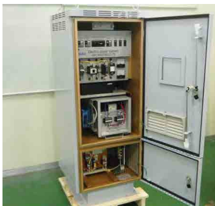
交通信号制御機の内部：和幸製作所撮影
