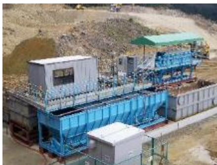
弊社実績による 大規模用排水処理プラント例
