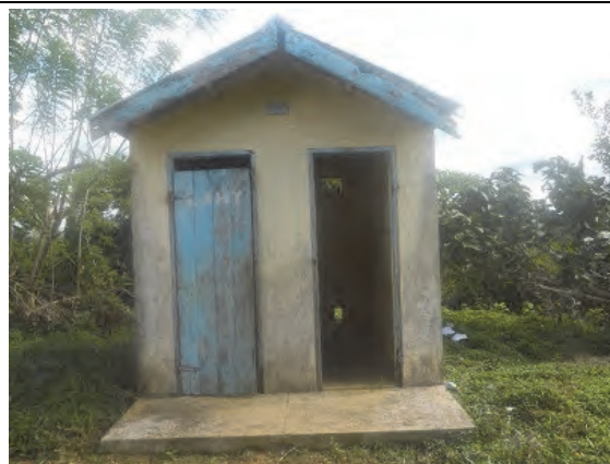
写真 I-20: 壊れかけたトイレが2ブースあるのみで、給水設備の設置がない。 (BR-4 EPP Ampitabe)
