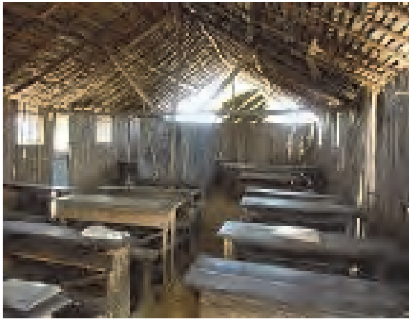
写真 I-3: サイクロン被害への対応として、保護者会により設置された仮設教室。
