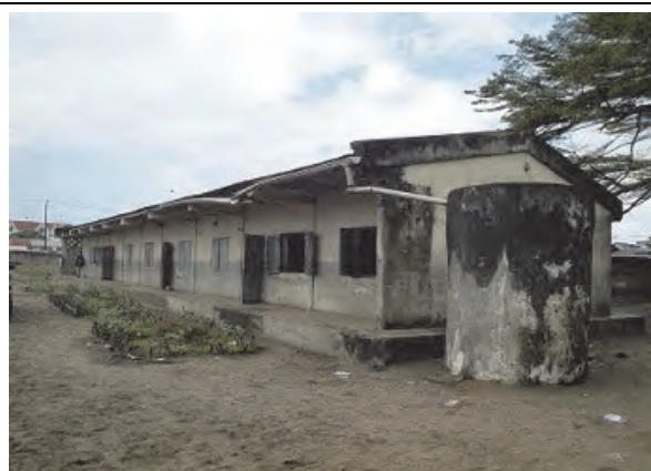
写真 I-22: 雨水貯留槽が設置されているものの、桶の一部が破損している。 (T I-5 EPP Todivelona Raphael)
