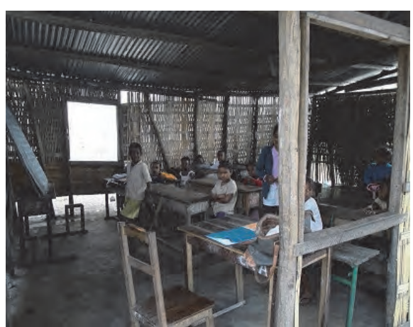
写真 I-10: 仮設教室内部の様子。壊れかけた壁面と暗い室内。 (T I-12 EPP La Poudrette)
