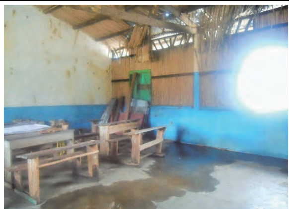
写真 I-12: 老朽化が激しく、雨漏りがする教室。 (VA-5 EPP Ambodivontaka)
