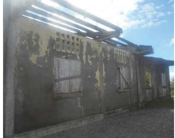
写真 I-2: 写真 I-1 同様、サイクロン被害を受け屋根が飛ばされた校舎。
