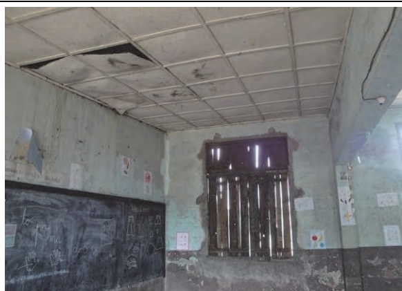
写真 I-11: 天井のはがれ、窓の破損、壁などの塗装のはがれ等、老朽化が激しい教室。 (T I-7 EPP Valpinson)
