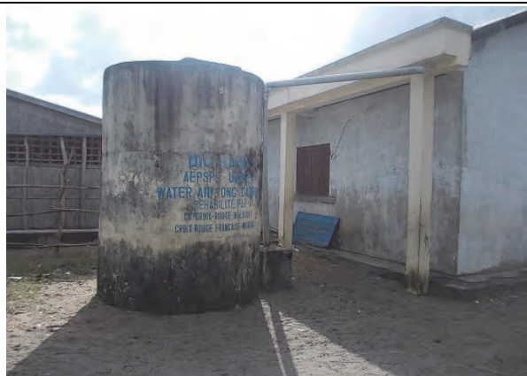
写真 I-21: 既存の雨水貯留槽の様子。 (T II-4 EPP Ambodisaina)
