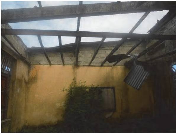
写真 I-1: サイクロンにより屋根が飛ばされ、使用不能となっている校舎。
