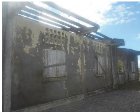
写真 I-2: 写真 I-1 同様、サイクロン被害を受け屋根が飛ばされた校舎。
