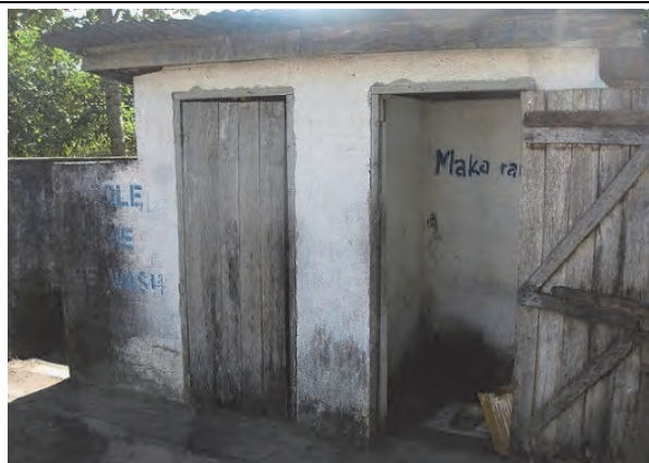
写真 I-19：校長住居脇に位置する老朽化したトイレ。児童も利用している。 (T I-1 EPP Zoto)
