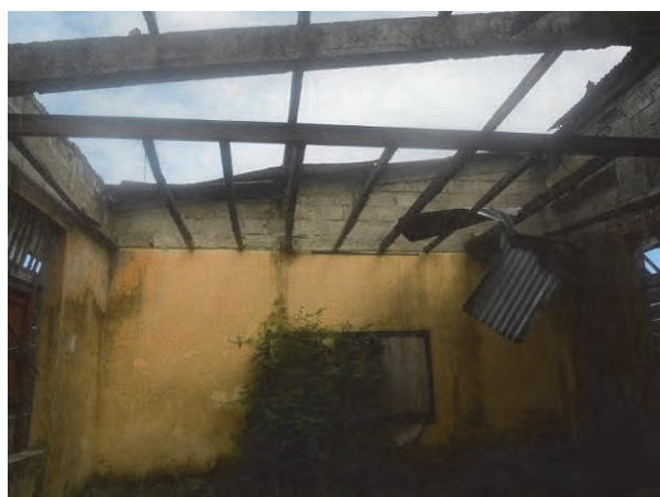
写真 I-1: サイクロンにより屋根が飛ばされ、使用不能となっている校舎。
