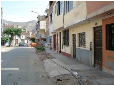
円借款事業「リマ首都圏北部上下水道 最適化事業」工事現場①
