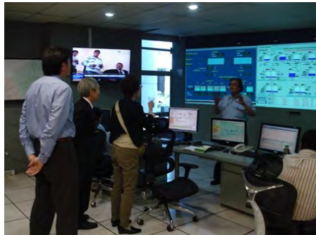
SEDAPAL 本部の SCADA 制御室
