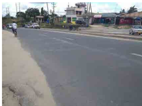
路面にひび割れが発生、補修を行っている。CBR試験の試料採取区間
