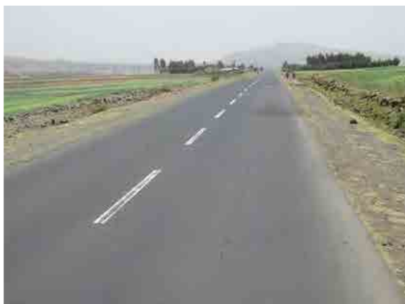
部分的な不具合が見られる箇所
