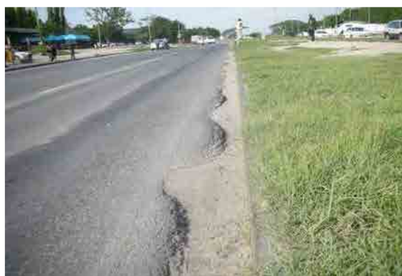
わだち掘れ（側方流動）等の損傷
