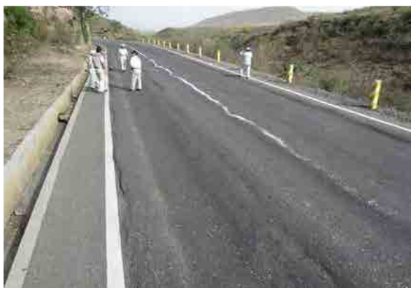
急勾配区間に発生した流動わだち掘れ
