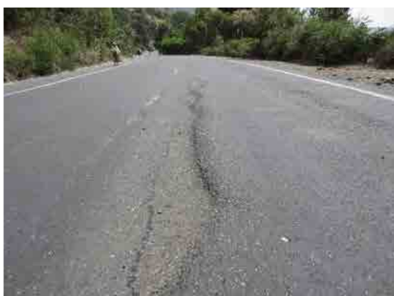
急勾配区間に発生した側方流動
