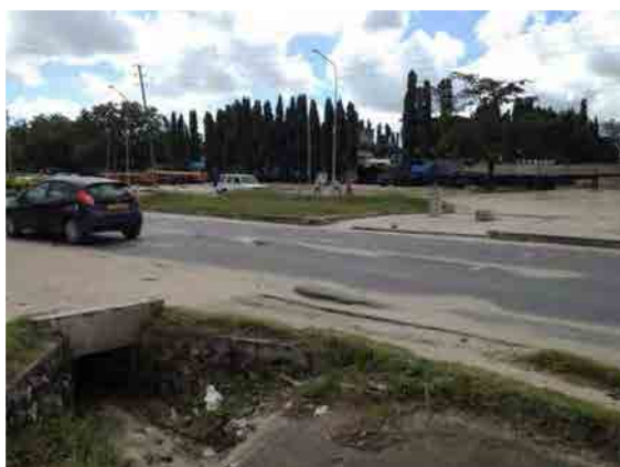
路肩側にわだち掘れ(側方流動)が発生。CBR試験の試料採取区間
