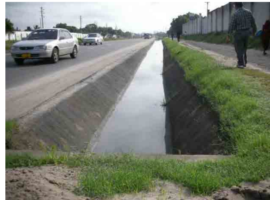
写真 3.4 併設される大型側溝
