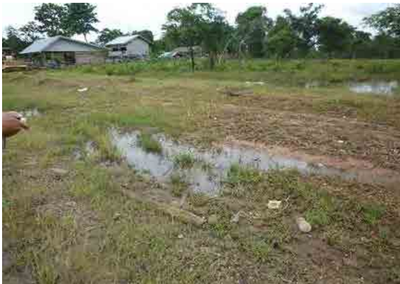
写真 5.9 土側溝が埋まり滞水している状態
