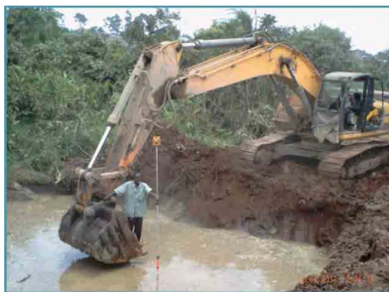
写真 5.4 施工時の湧水（地下水）（2）
