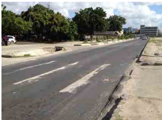
建設後7年経過しており、一部区間で路面損傷が発生。交通量測定箇所
