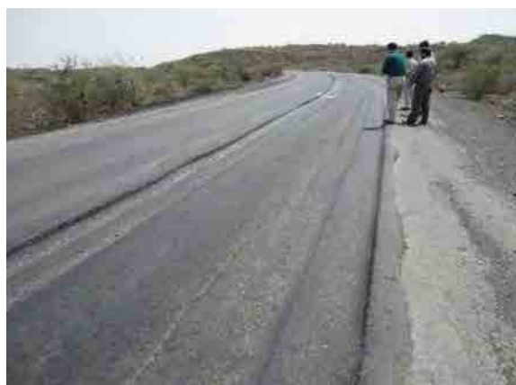
深刻な不具合が見られる箇所
