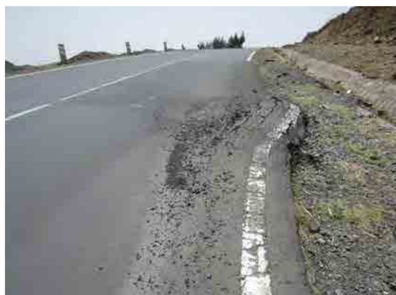
山側からの地下水で山側のレーンが破壊している
