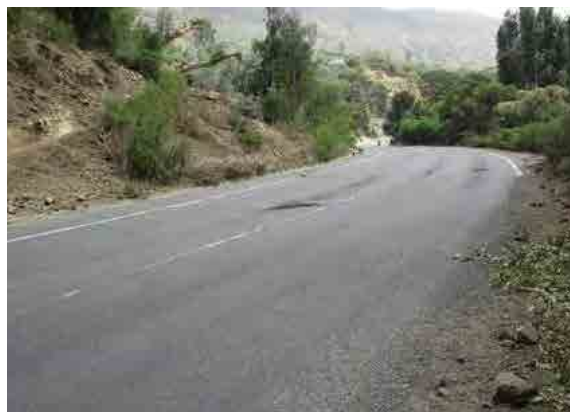
小曲線部の流動わだち掘れ
