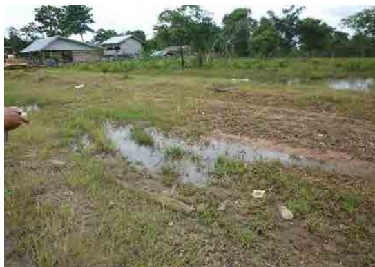
写真 4.12 土側溝が埋まり滞水している状態
