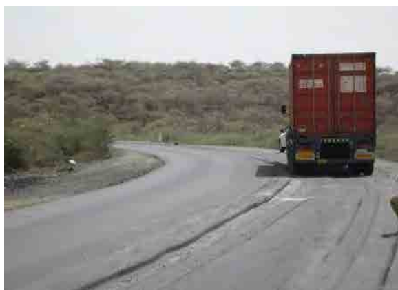
曲線部の損傷
