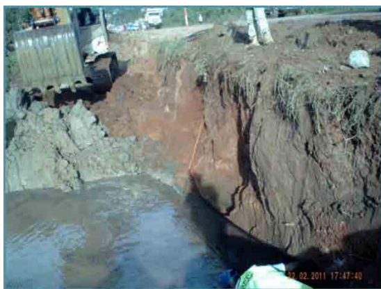
写真 5.3 施工時の湧水（地下水）（1）
