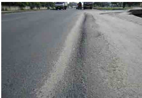
わだち掘れ（側方流動）等の損傷
