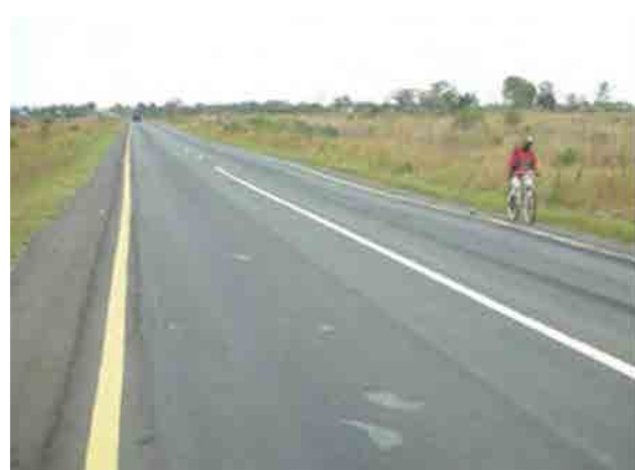
わだち掘れ（側方流動）等の損傷
