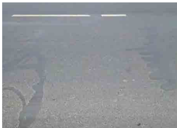
ひび割れをシール注入材で補修。CBR試験の試料採取区間
