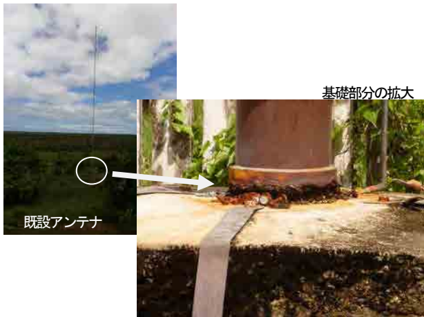
ナウル送信所既設アンテナ
