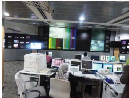
KL市信号管制センター
