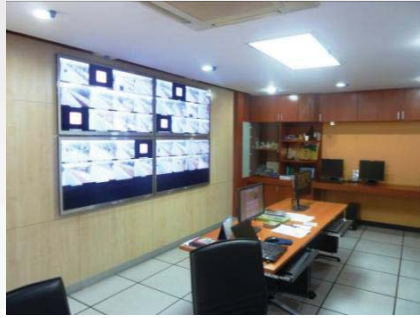
CCTVモニタリングルーム(DOH)
