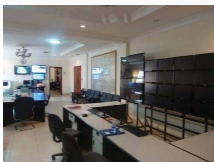
CCTVセンター(MOI)
