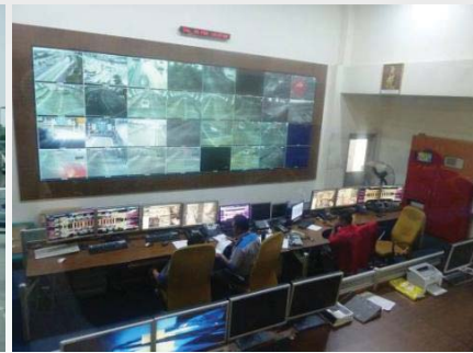
SMARTトンネル管制センター
