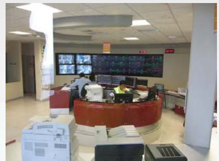
Metroコントロールセンター
