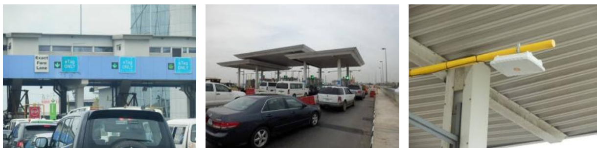
Lekki-Epe Expressway ETC ゲート Lekki-Ikoyi Bridge ETC ゲート Lekki-Ikoyi Bridge ガントリー路側アンテナ
