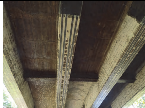
炭素繊維を用いたコンクリート桁補修を パイロット工事にて実施
