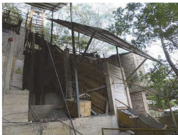
Foto 4-4 Instalaciones de la descarga de mineral
