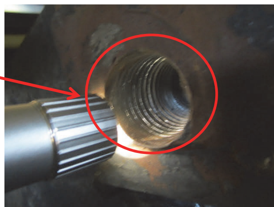
(h) ネジ山が摩耗した取付け部
