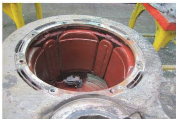
(b) 絶縁含浸塗装された固定子（外見上は良好）
