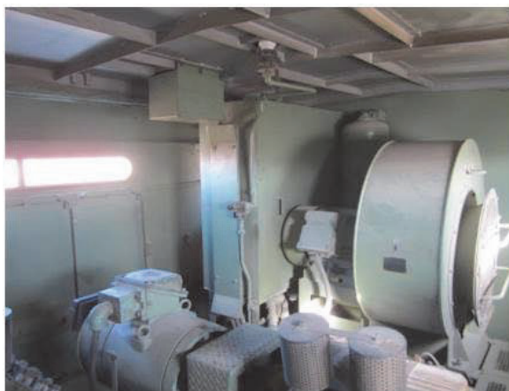
(a) 稼働中の送風機（ブロー）
