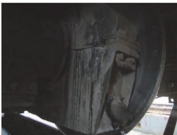
(e) 点検中の機関車 (E1108) の油漏れ
