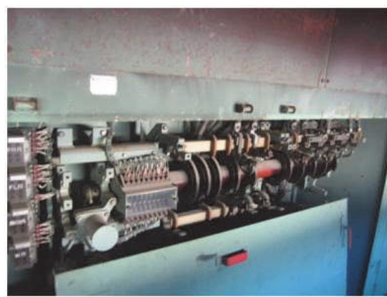
(h) 主制御器 カム接触器部
