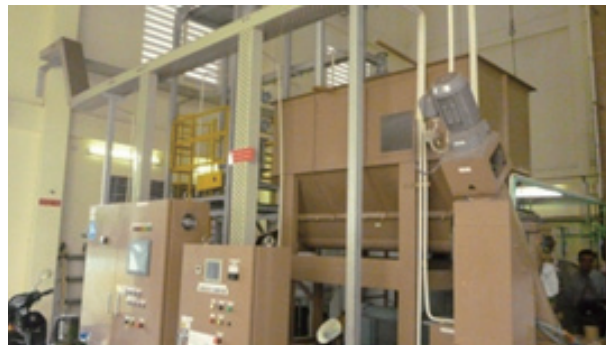
4 タイミー村プラント内部
