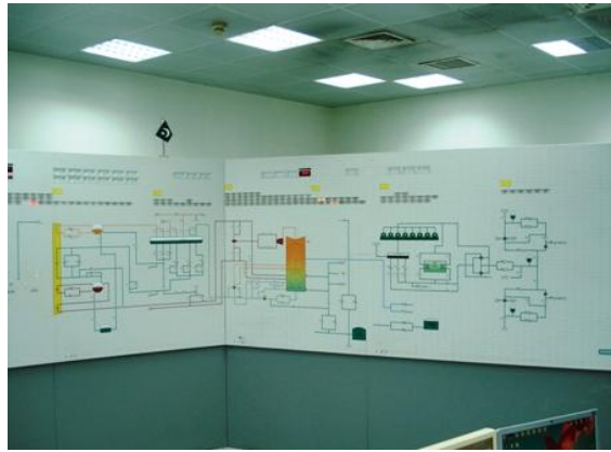
Photo 4-4 Monitor board for HRSG
