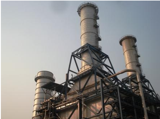
Photo 4-1 HRSG and stacks
