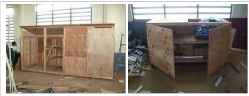
図 3-3 スペアパーツ・工具消耗品収納庫
