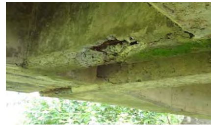
桁コンクリートの剥離
