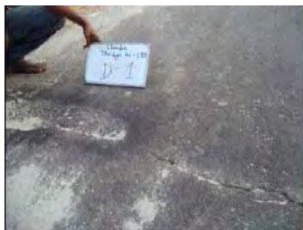
床版のクラック
