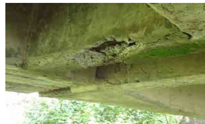
桁コンクリートの剥離
