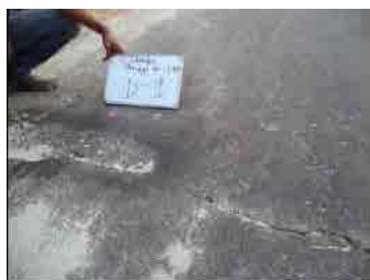
床版のクラック
