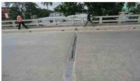
伸縮継手の損傷 (構造上致命的な損傷でない)
