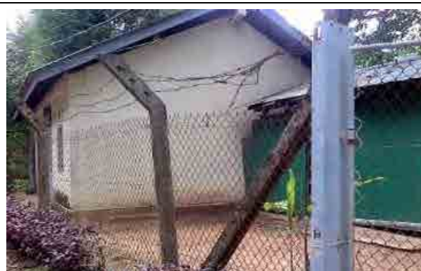
写真 1-1：カンポット市既設取水場（2014年6月） 取水能力：5,760m 3 /日
