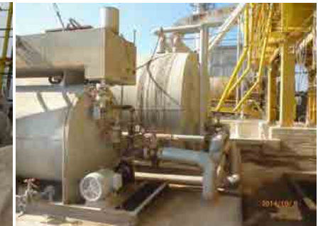
ホットオイル (熱媒体油) 循環ポンプ付近
