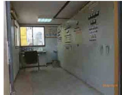
制御室内部全景
