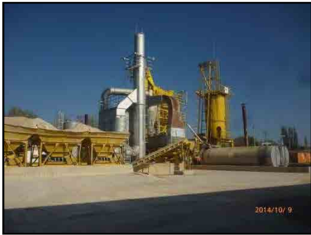
アスファルトプラント全景
