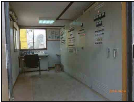
コントロールルーム内部
