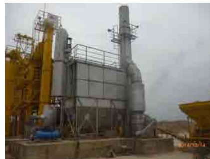
集塵装置全景その1
