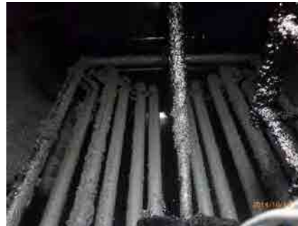
アスファルトタンク内の加熱管
