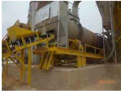
骨材コンベヤー、ドライヤ
