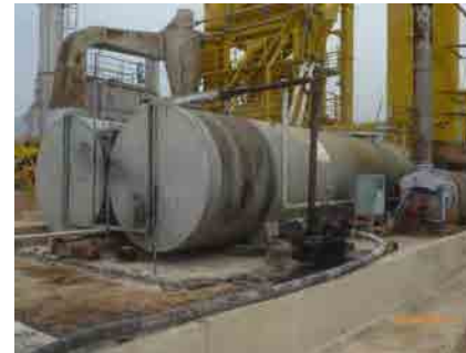
アスファルト供給装置全景
