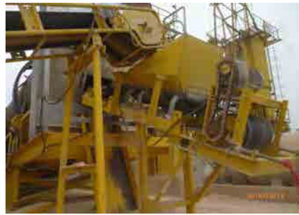
骨材コンベヤー
