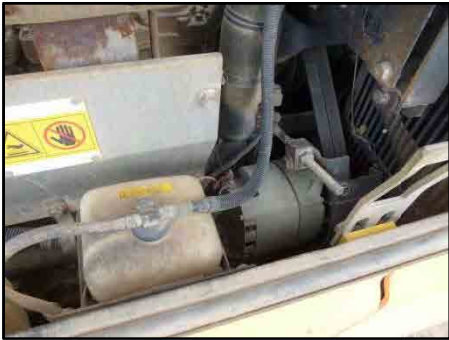
現地調達した発電機 (ブルドーザ)
