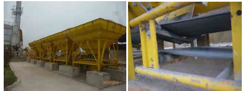
コールドビン、ベルトフィーダー、ベルトコンベヤー
