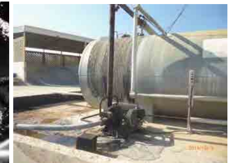
地上設置のギヤポンプ (客先で交換している)
