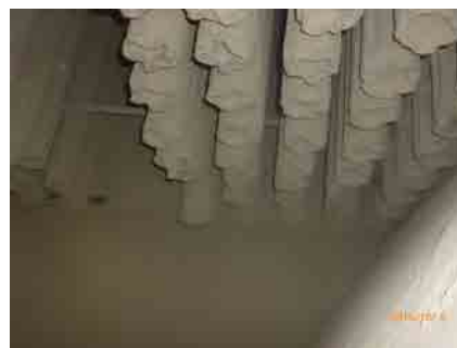
バグフィルタ内部(破れた濾布あり)
