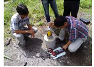
Suivi des mouvements à la surface de glissement (par inclinomètre de forage)
