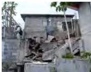
Glissement de terrain Landslide à Vallée Pitot
