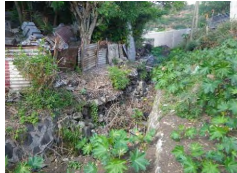
水路の側壁が見えるが水路は土砂で埋まっている
