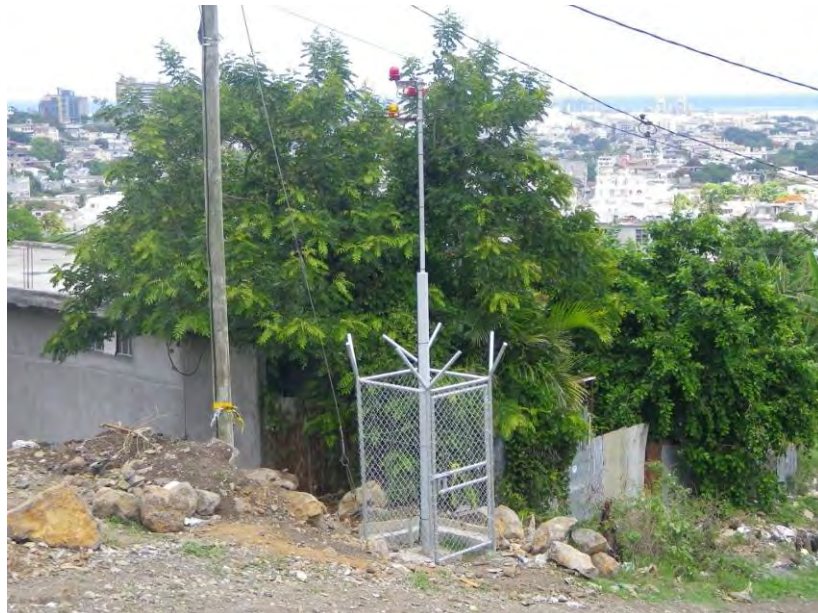
写真6.2.3 Vallee Pitot 地区での早期警戒システムの設置状況(出典: JICA 調査団)
