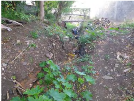
土塊の押し出しにより水路が全く見えない
