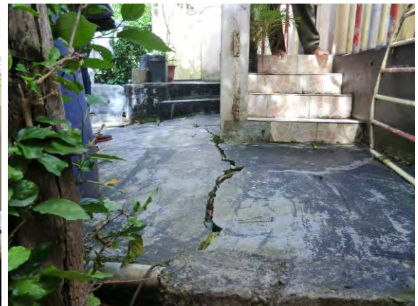
写真3.7.80 コンクリート基礎の開口亀裂
