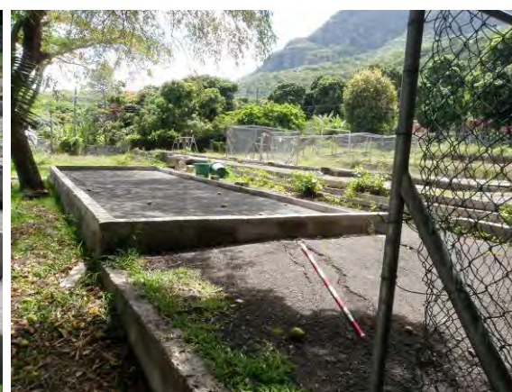
写真3.7.8 東西方向に断続する亀裂
