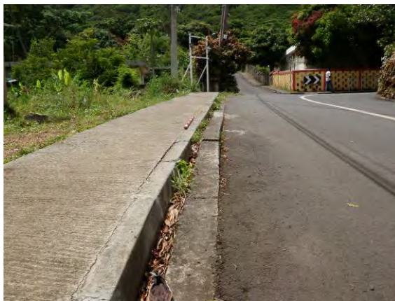
写真3.7.21 縁石の開きと段差
