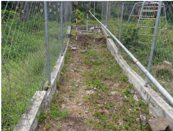
写真3.7.9 伸縮計 E(5)に認められる段差
