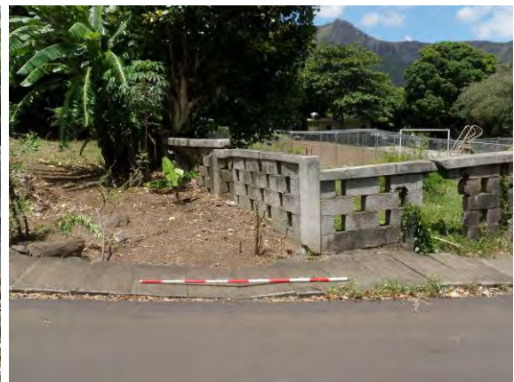
写真3.7.12 道路側水路の沈下
