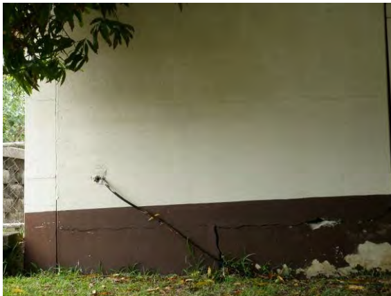
写真3.7.16 壁面基礎付近の亀裂
