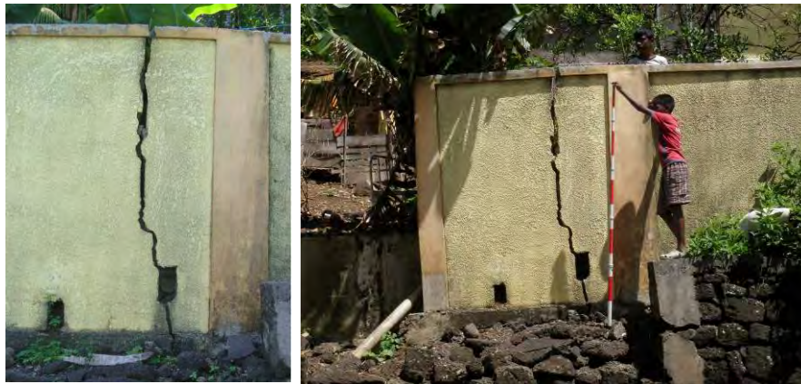
写真3.7.86 コンクリート擁壁の亀裂(左:2011,右:現在) (出典:JICA 調査団)
