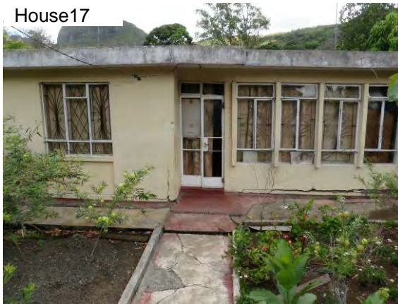
写真3.7.19 損傷の大きい人家
