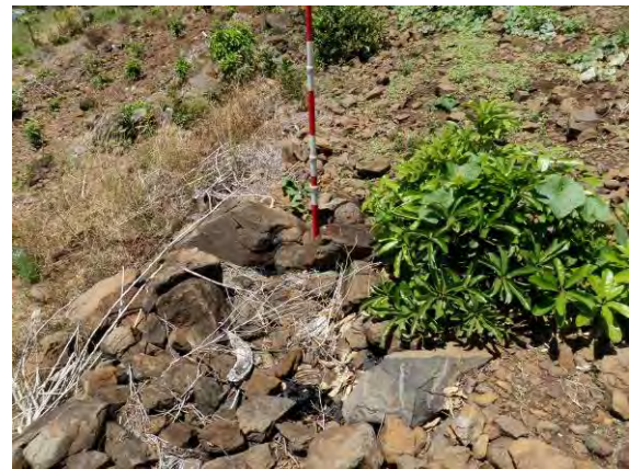
写真3.7.67 標高 45m 付近の変状(現況)
