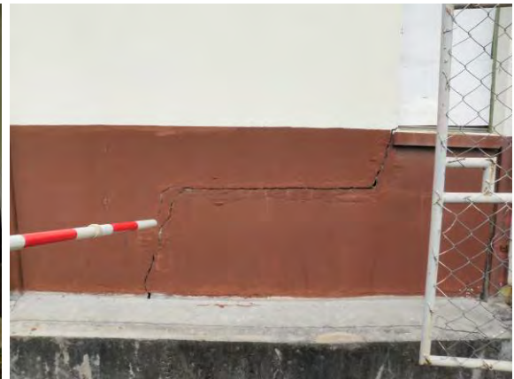
写真3.7.17 校舎隅角部の亀裂
