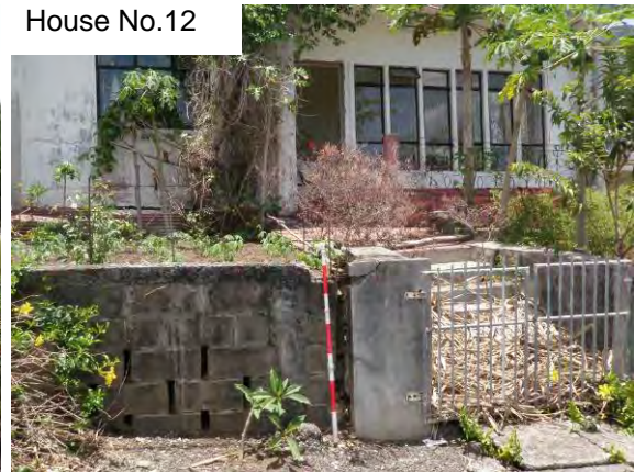
写真3.7.46 人家や擁壁に開口亀裂が発生
