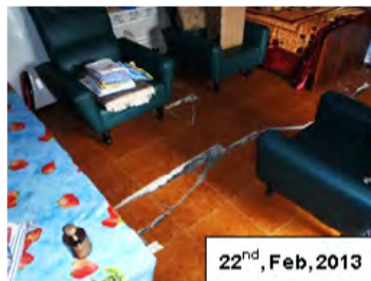
写真3.7.94 House (1)の室内の床の段差（出典：JICA 調査団）
