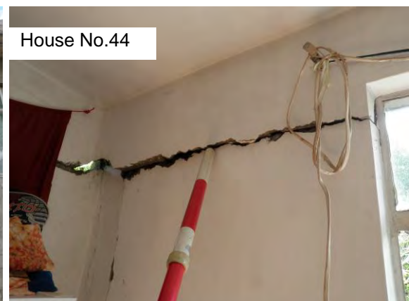
写真3.7.37 水平に延びる開口亀裂
