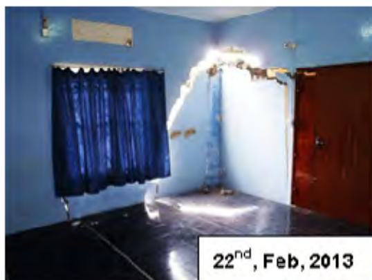
写真3.7.95 House (1)の室内の開口クラック （出典：JICA 調査団）
