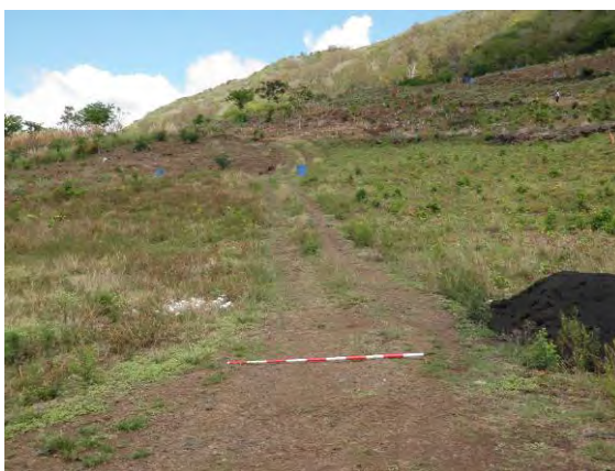
写真3.7.68 農道に発生した亀裂(下方より)
