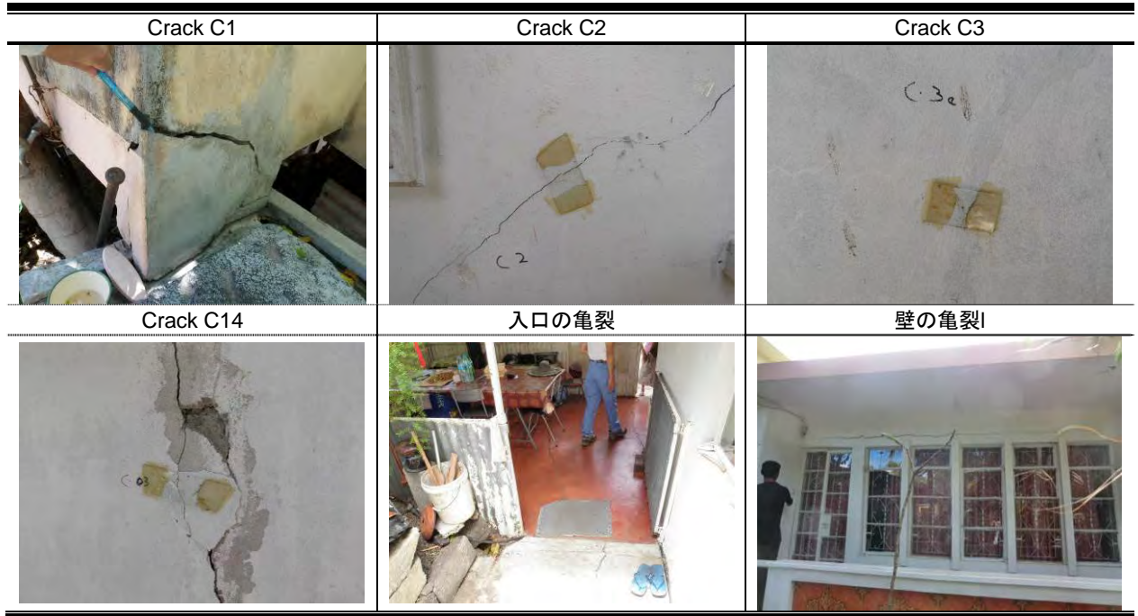
写真3.7.1 House1 の亀裂状況（出典：JICA 調査団）
