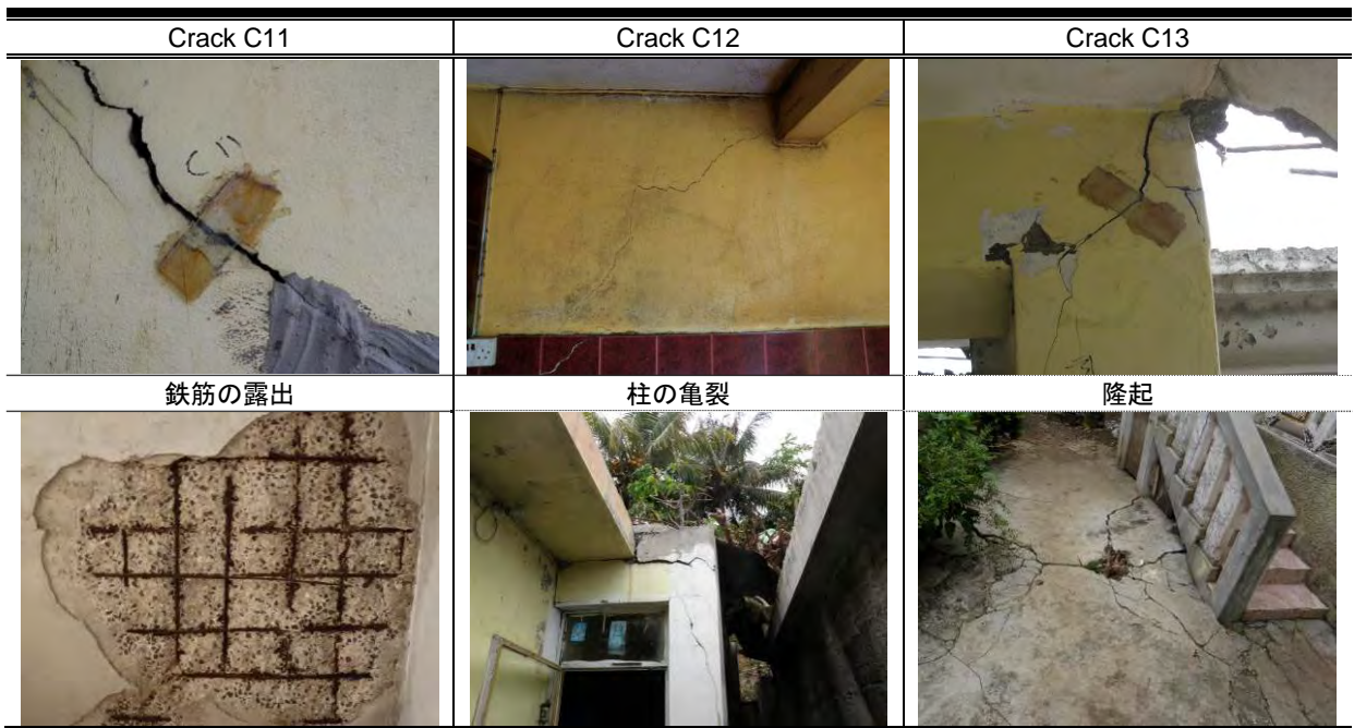
写真3.7.4 House19 の亀裂状況（出典：JICA 調査団）
