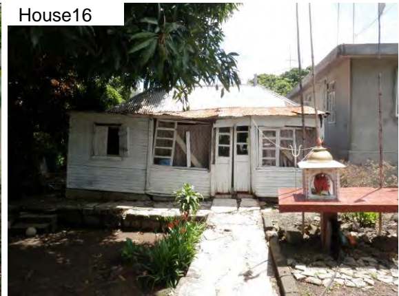
写真3.7.20 損傷の大きい人家
