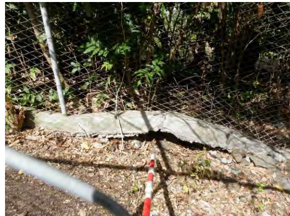
写真3.7.35 保護柵基礎コンクリートの変状（出典：JICA 調査団）
