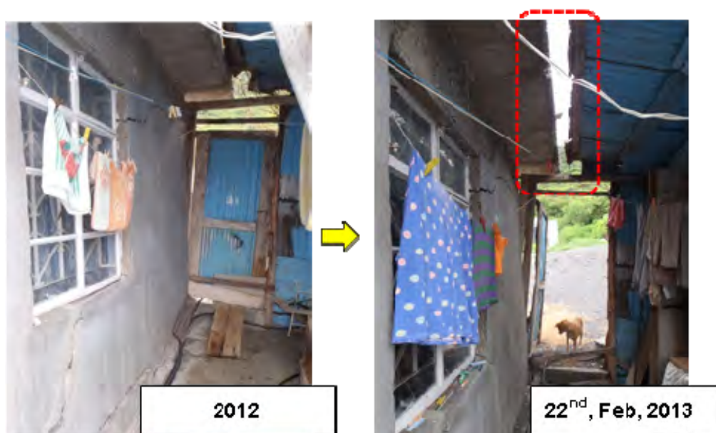
写真3.7.93 地すべり活動によって House (1)と隣家との隙間（出典：JICA 調査団）
