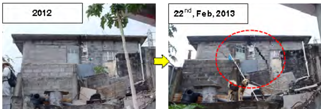
写真3.7.92 地すべりの被害を受けた家屋の外壁 (出典: JICA 調査団)
