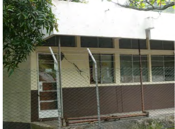
写真3.7.15 校舎壁面に発生した亀裂
