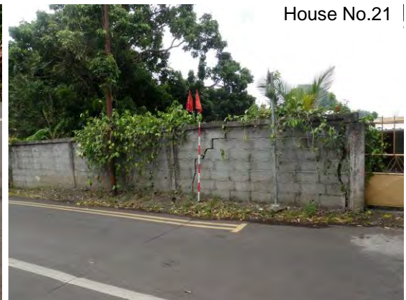
写真3.7.22 小学校前の人家擁壁の亀裂
