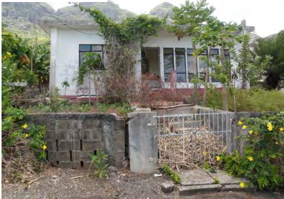
写真3.7.45 損傷の大きい人家
