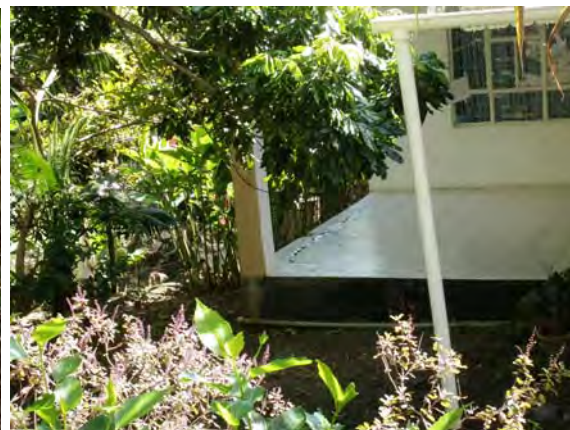
写真3.7.24 ベランダ端の亀裂
