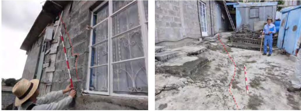
写真3.7.89 被害家屋・House(1)（出典：JICA 調査団）
