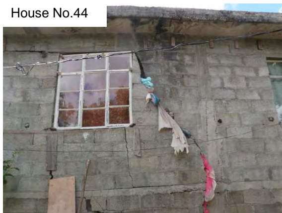
写真3.7.36 人家壁面に発生した亀裂
