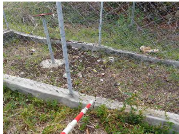
写真3.7.39 保護柵基礎コンクリートの変状（出典：JICA 調査団）
