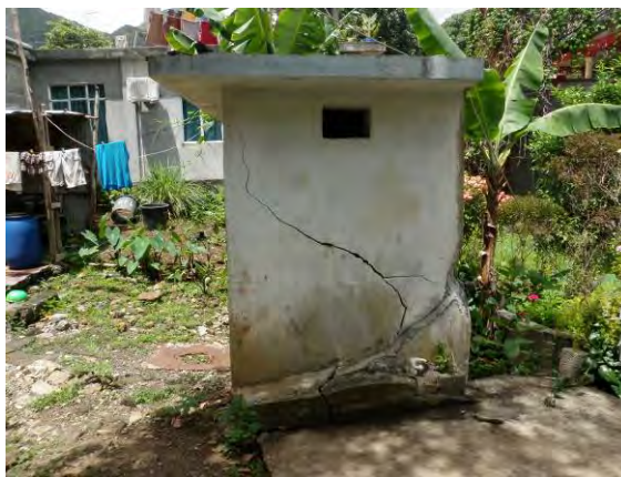
写真3.7.27 コンクリート構造物の亀裂
