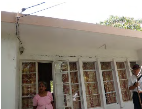
写真3.7.79 壁面に水平に延びた亀裂
