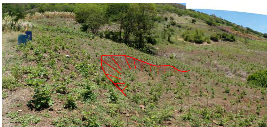
写真3.7.73 谷地形上部の崩壊跡地（出典：JICA 調査団）
