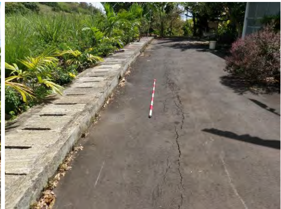
写真3.7.75 路面に発生している亀裂
