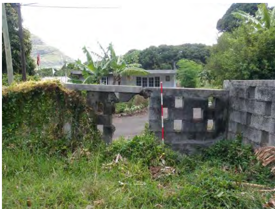
写真3.7.11 擁壁の破損(道路側)
