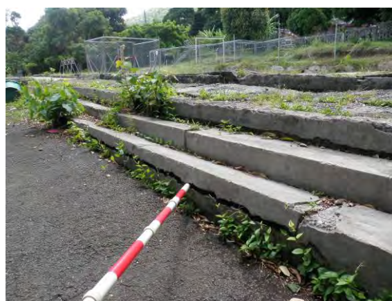
写真3.7.7 変状の大きい階段付近
