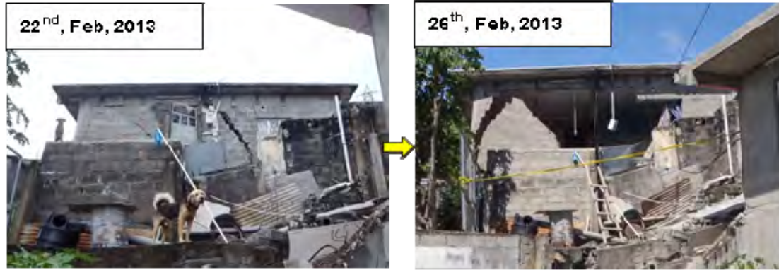
写真3.7.96 House (1) の外壁の倒壊状況（出典：JICA 調査団）
