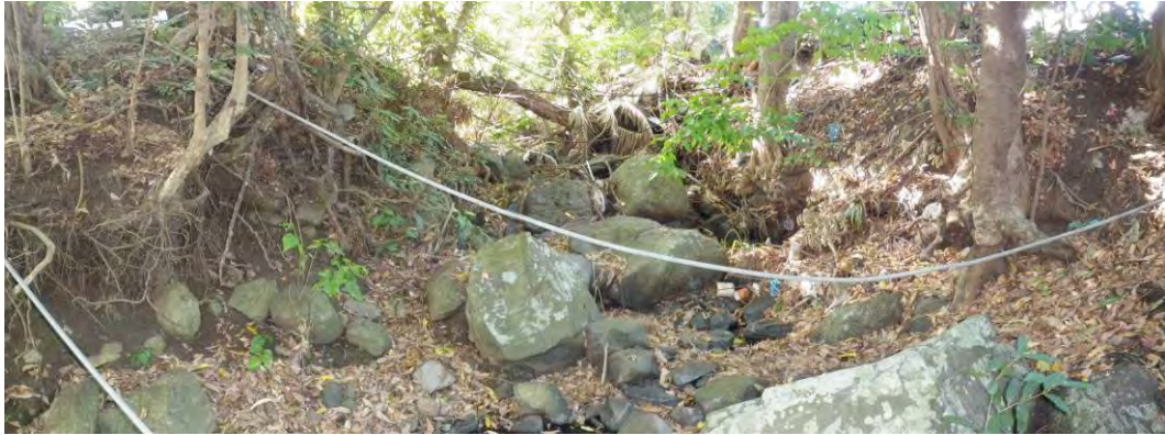
写真3.7.44 溪岸浸食の進行状況(上流側) (出典: JICA 調査団)
