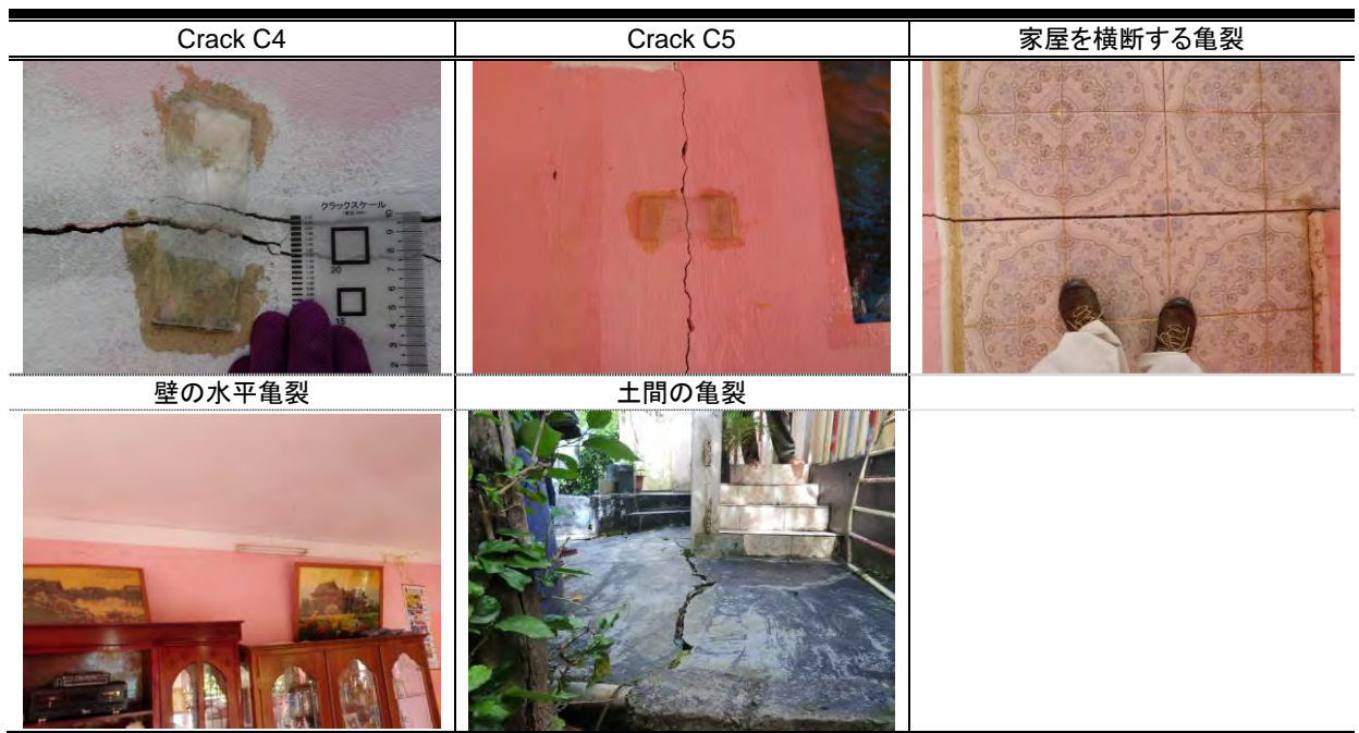
写真3.7.2 House2 の亀裂状況（出典：JICA 調査団）
