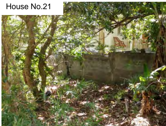
写真3.7.23 人家側の擁壁の亀裂
