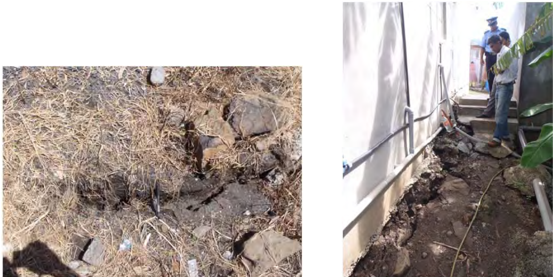
写真3.7.97 House(1)の上方(山側)で見つかった新しい開口クラック（出典：JICA 調査団）
