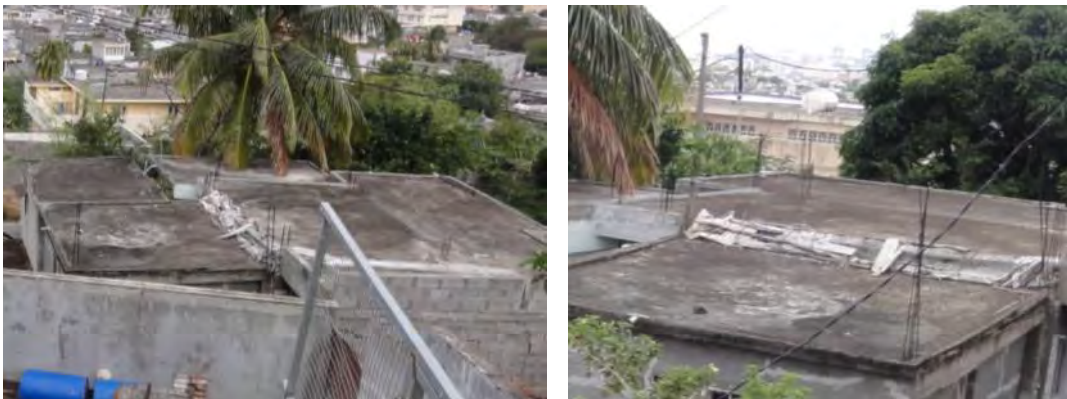
写真3.7.91 被害家屋・House(2)（出典：JICA 調査団）
