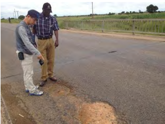
Kaleya Br. 橋面上、舗装ポットホールのため、コンクリ ート床版が露出してしまっている。
