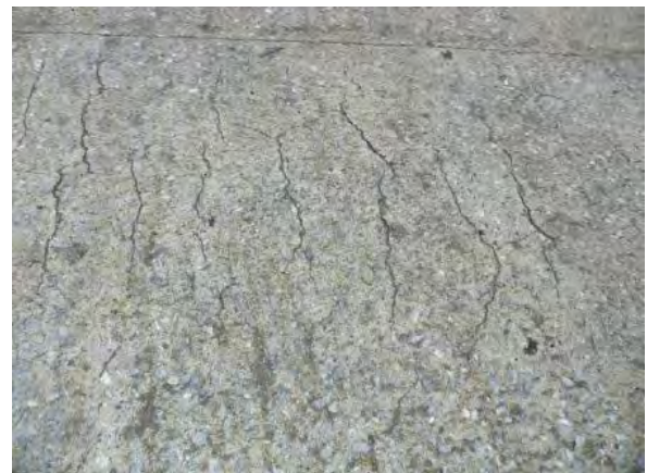
Luanguwa Br. コンクリート床版上、橋軸方向に多くのクラックが発生している。
