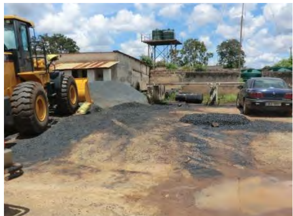
Kabwe Regional Office 舗装パッチング等、簡単な補修は RDA で行っている。
