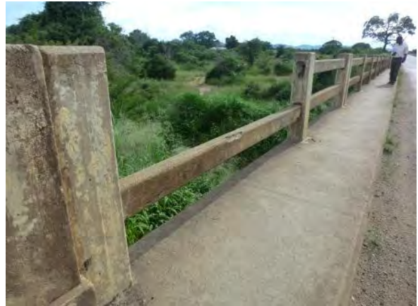
Nansenga Br. 壊れたままのコンクリート高欄
