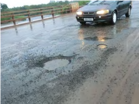
Muwanbashi Br. 橋面に発生したポットホール。既にコンクリート床版が表れているため、水が床版内に漏水している可能性が高い。
