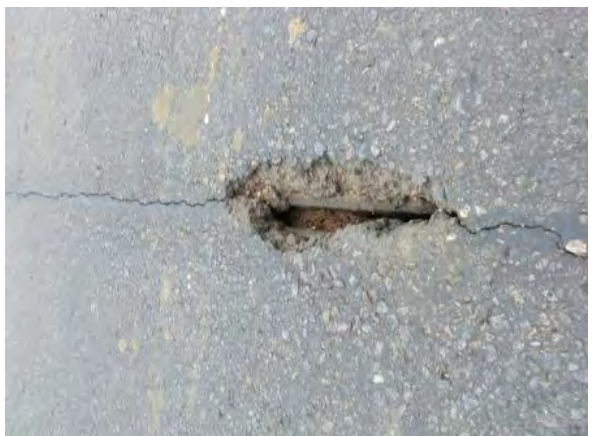
Kaleya Br. 伸縮装置が設置されていないため、舗装がは がれ漏水している。
