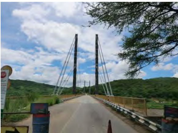
Luanguwa Br. 1968年に建設され、2000年に補修補強された鋼斜張橋。橋長 308m (40+228+40)。通過車両による振動たわみが激しく耐荷力に問題あり。現在1車線の片側交互通行を行っている。
