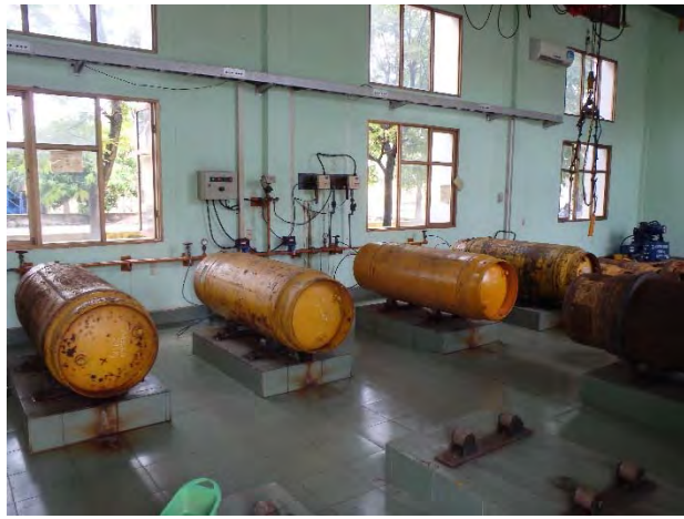
写真-13：アンズオン浄水場塩素注入施設
