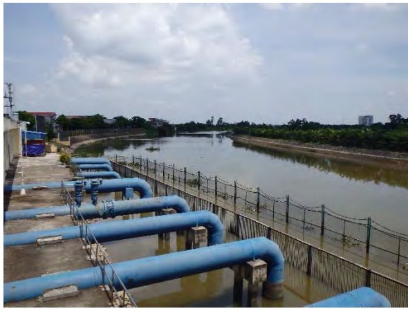
写真-1：既設取水口（クワンピン取水場） レ川から取水し、水質悪化時は浄水場に導水する前にここで塩素を注入している。取水管口径はφ800mm×12.295m×8本である。
