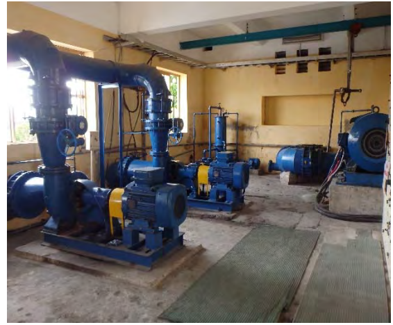
写真-8：アンズオン浄水場逆洗ポンプ
