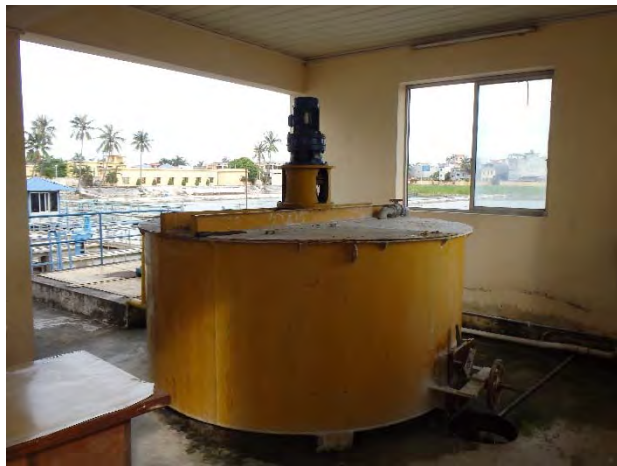
写真-15：アンズオン浄水場 硫酸アルミニウム注入施設
