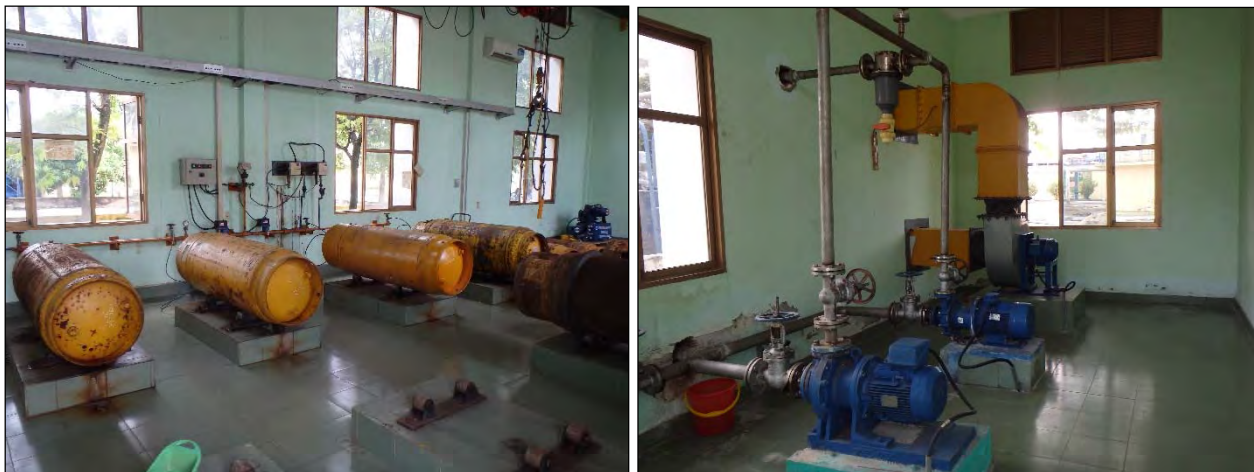
写真 2-1-13 塩素注入設備
