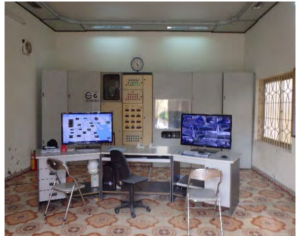
写真-16：アンズオン浄水場監視室
