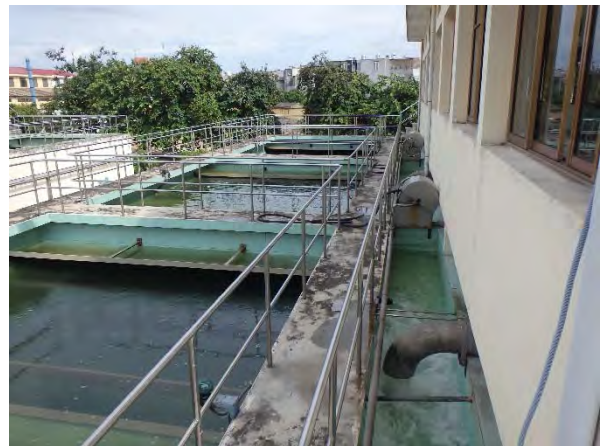
写真-6：アンズオン浄水場急速ろ過池 1つのろ過棟に6つの池があり、ろ過棟が3つあることから18池が現在稼働中である。内訳は面積55m 2 が12池、48m 2 が6池となっている。
