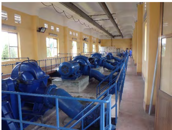
写真-5：アンズオン浄水場中間ポンプ 沈澱池の上澄水をろ過池に送るためのポンプで75kw-1台、160kw-1台、200kw-2台、250kw-1台となっている。
