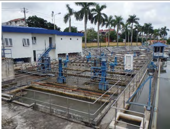
写真-3：アンズオン浄水場薬品混和池/フロック形成池 凝集剤としてPACを注入し、フロックを形成している。ミキサーは15kw×238rpm×2台、3kw×30rpm×8台。
