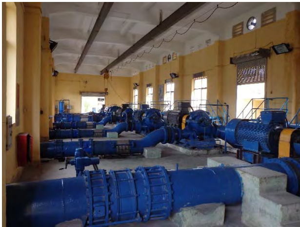
写真-9：アンズオン浄水場配水ポンプ
