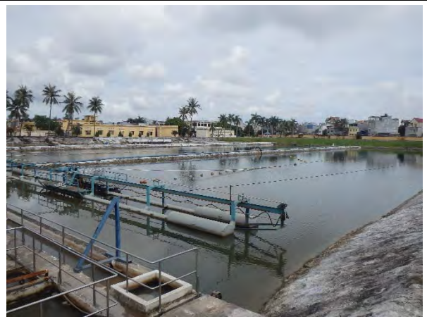
写真-4：アンズオン浄水場沈澱池 横流式沈澱池であり、十分な大きさを持っている。掻き寄せ機も備えられており、維持管理は十分に行われている。長さ112m×幅32m×2池。
