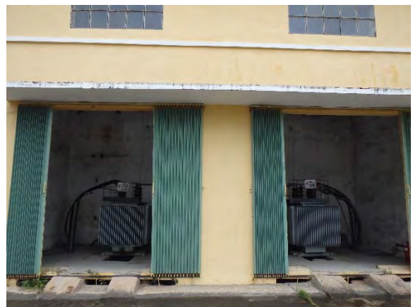
写真-18：アンズオン浄水場変圧器
