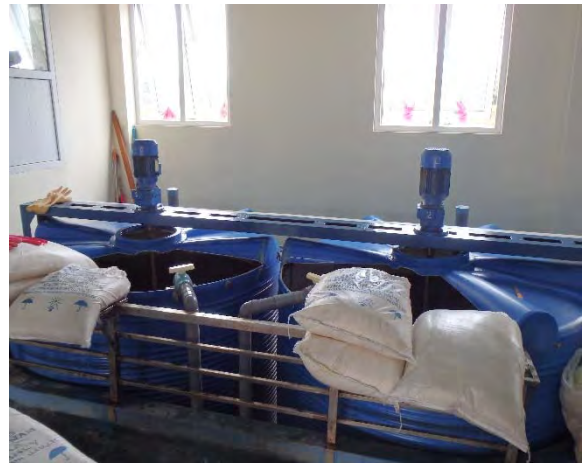
写真-14：アンズオン浄水場 PAC 注入施設
