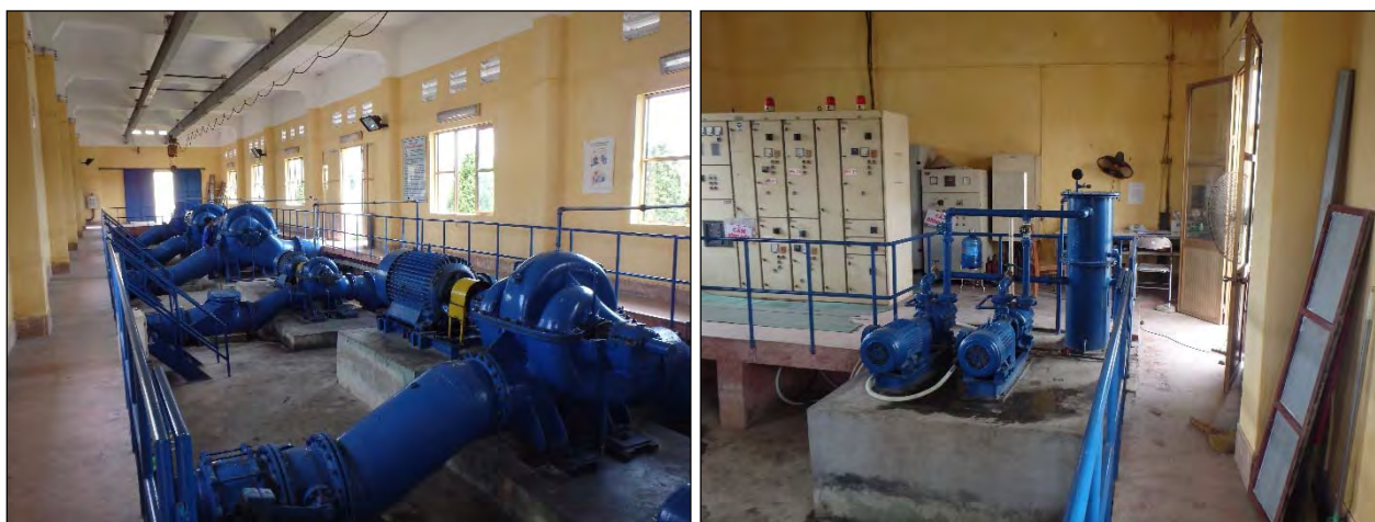
写真 2-1-8 中間ポンプ棟
