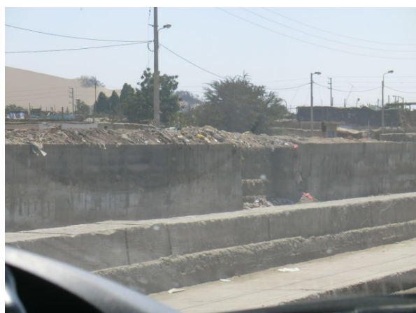
Río Ica (protección de márgenes: pared vertical de hormigón en la margen opuesta, y revestimiento de hormigón en la margen del primer plano)
