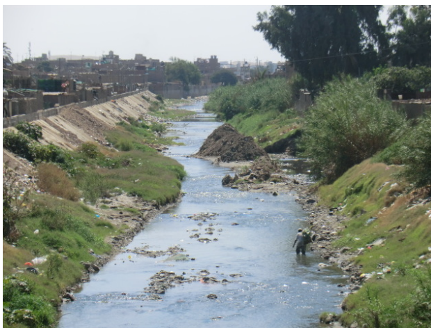
Figura 4.4.1 Defensas ribereñas construidas por los gobiernos provinciales sin un plan general y área residencial densa ubicada en el interior del dique vulnerable a inundaciones
