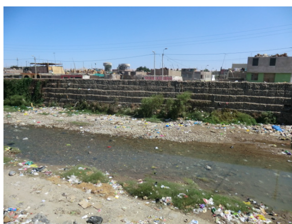
Río Ica (protección de márgenes con gaviones): El ancho del río se reduce aguas abajo dentro de la ciudad de Ica)
