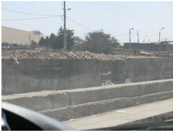
Ica 川（対岸直壁コンクリート護岸、手前コンク リート張護岸）※堤防高が左右岸で異なる
