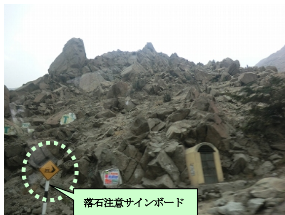
道路沿いにある落石注意サインボード（ただし落石防止フェンスや壁は設置されていない）
