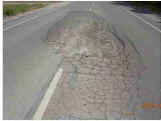
AC 舗装上の亀甲クラック ／アスファルト安定処理路盤露出
