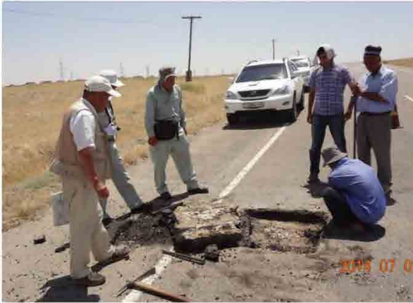
勾配部 AC 舗装のセメント安定処理路盤との 接着面調査状況
