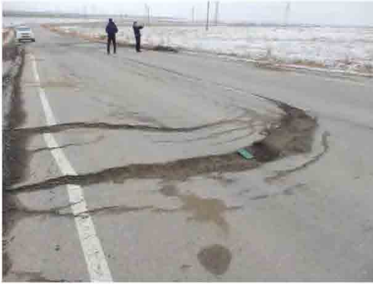
AC 舗装の滑動状況
