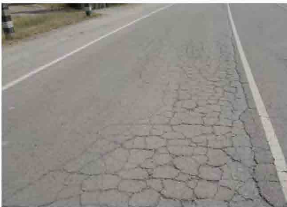
AC 舗装上の亀甲クラック
