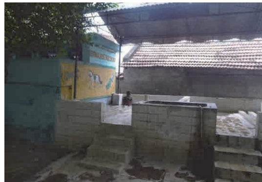
子供用トイレ (子供たちが怖がらないようにオープンスペース型)
