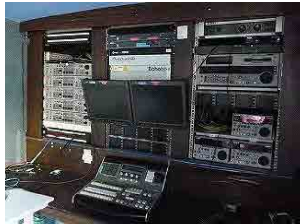
モルディブ公共放送局 中継車内部
