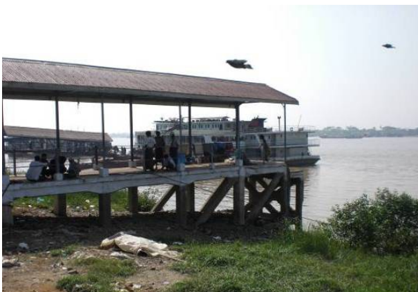
写真 6.2 Phoneygilan 棧橋の被災状況
